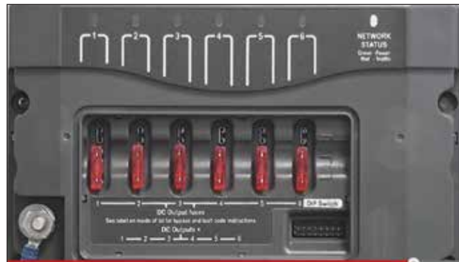
CZone Output Module Fuses
