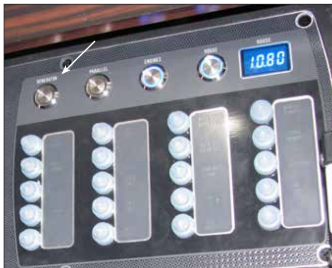
CZone Generator START/STOP Button
