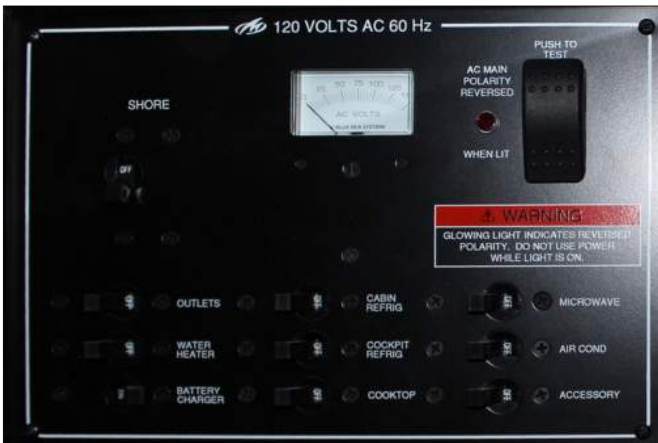
328SS 120 Volt AC Panel
