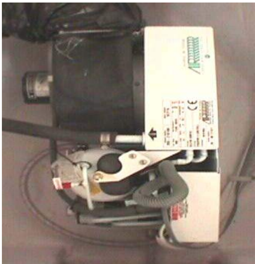
<fig. 8 – Air Conditioner>
