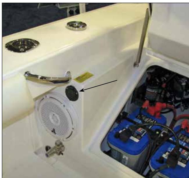
120 Volt Shore Power Inlet Connection
